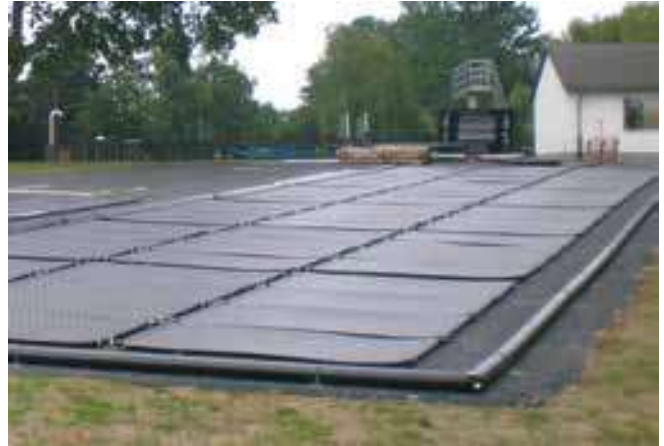
Instalación en espacio abierto
