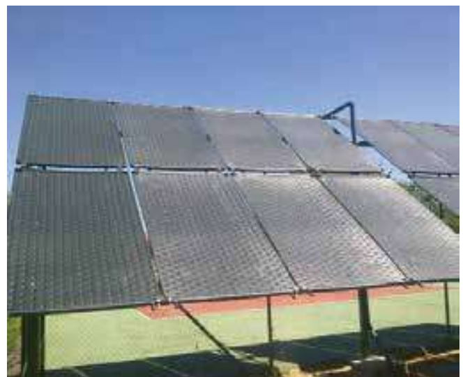
Instalación sobre estructura a medida
